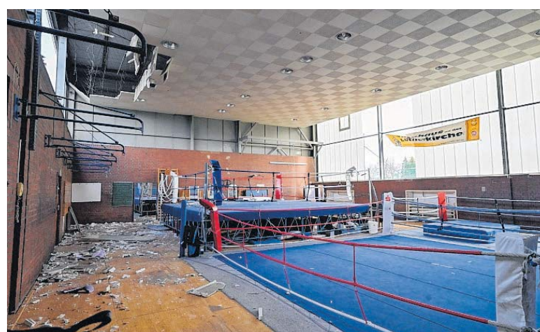
In der Boxhalle fielen auch Platten der Zwischendecke herunter.
